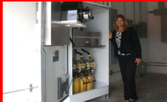
Nuestra compañera, Roxanne Gluck nos enseña el equipo solar utilizado en Mini Warehouse de Caguas.
